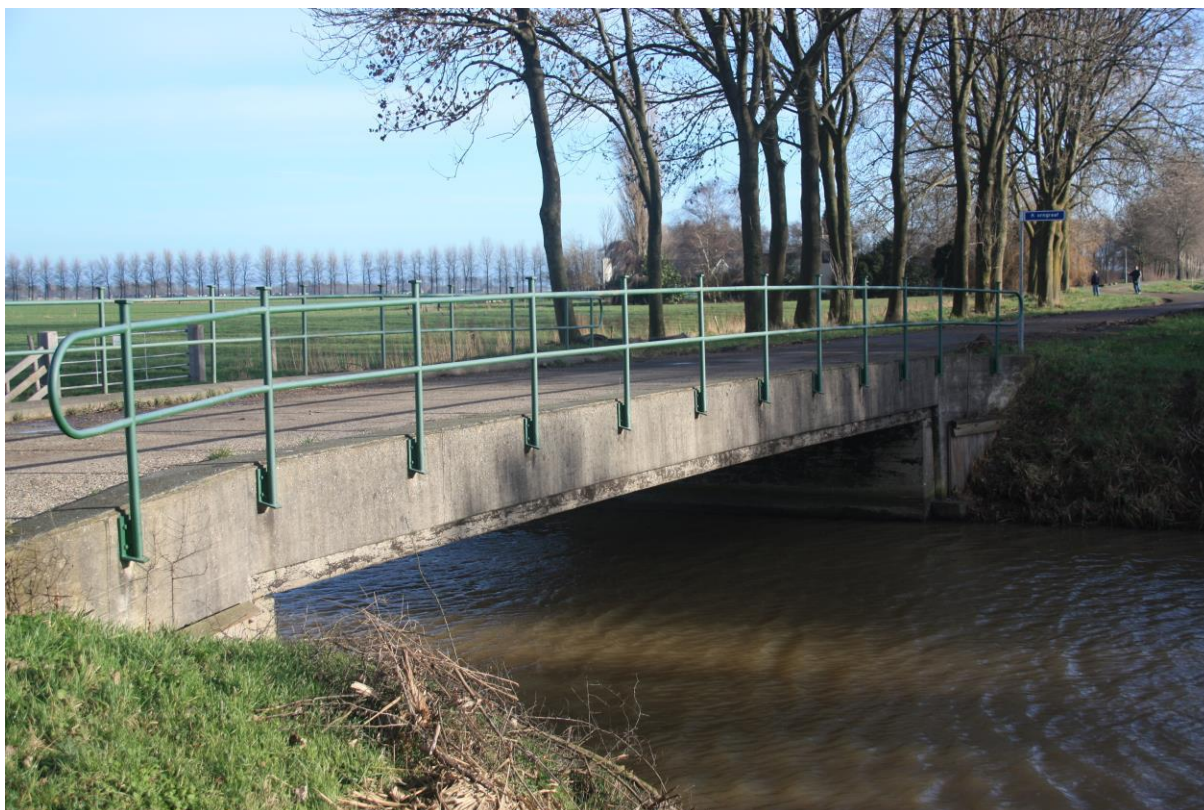
Figuur 148. Kenmerkend voor de ruilverkavelingsperiode zijn de betonnen bruggen met groengeschilderde leuning van stalen buizen. De brug op de foto is de brug van de Tiendweg over de Laarwetering in de Polder Asperen.
