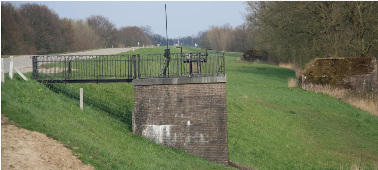
Figuur 121. De Nieuwe Zuiderlingedijk met twee groepsschuilplaatsen en op de voorgrond Duikersluis nr 4, die gesloten werd bij inundaties.
